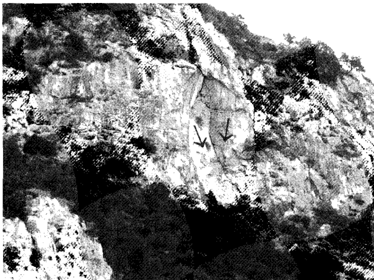
Φωτογραφία 1. Αστοχία σφίγας σημαντικών διαστάσεων στο δρόμο Αλεποχωρίου - Σίνιου.
